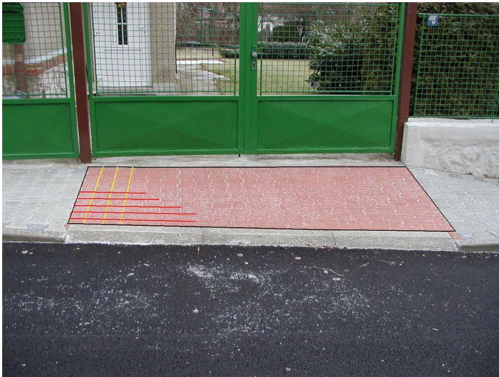
Nájezdy do vrat z nakloněné komunikace
